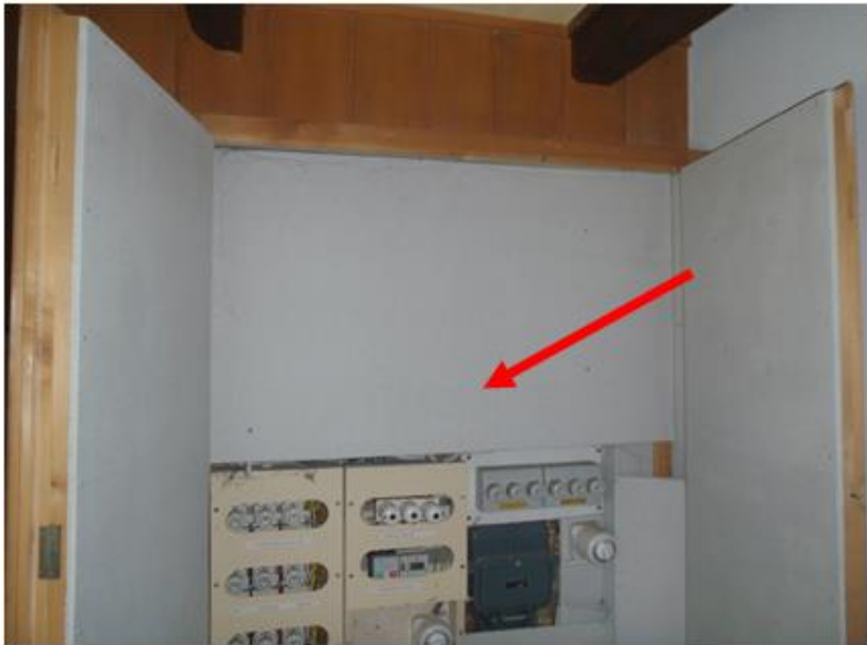
Asbestkarton in Sicherungskasten
